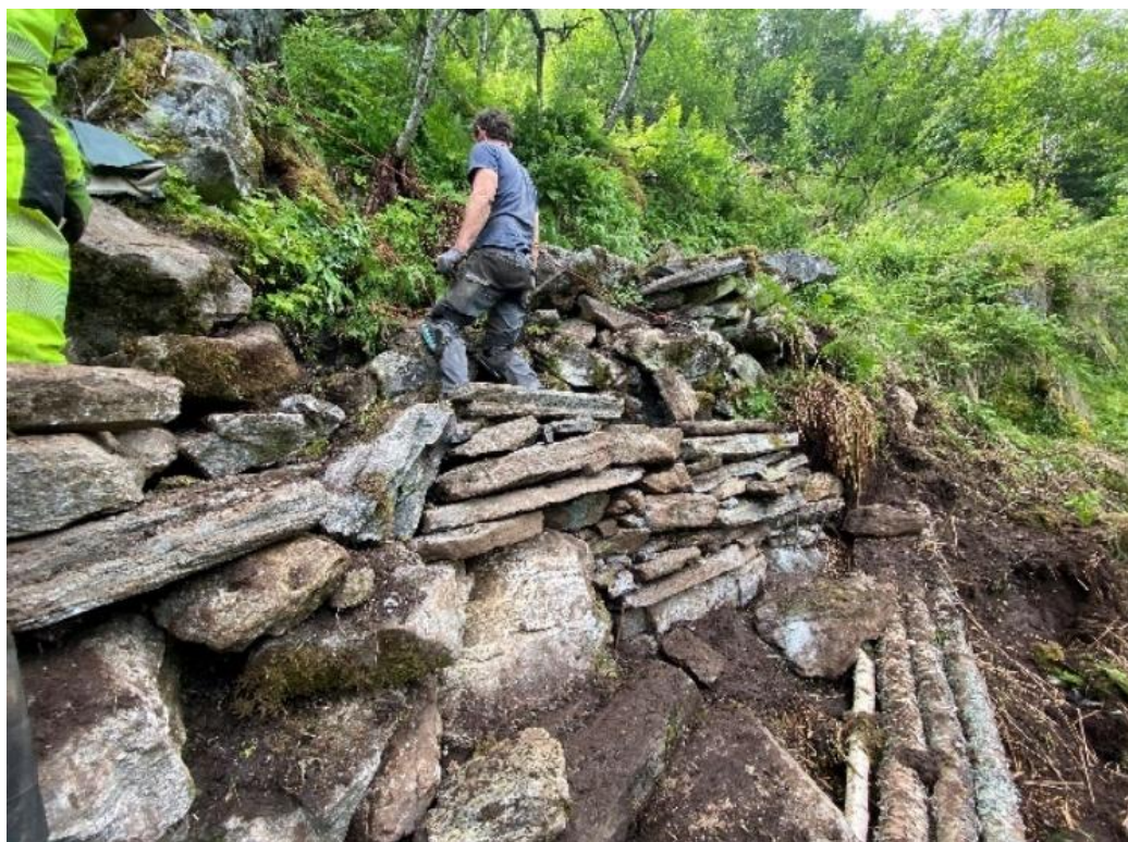
Sandal-karane i gang med naudtiltak på råsa mellom Homlung og Homlungsætra. Her var råsa i ferd med å kollapse.
